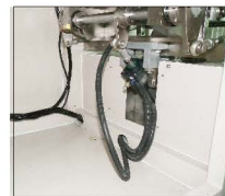
机箱内部密封 Seal up inside
